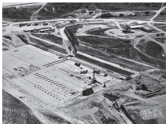
Construcción del depósito y la torre del agua dentro del parque Central. Año 1977.
